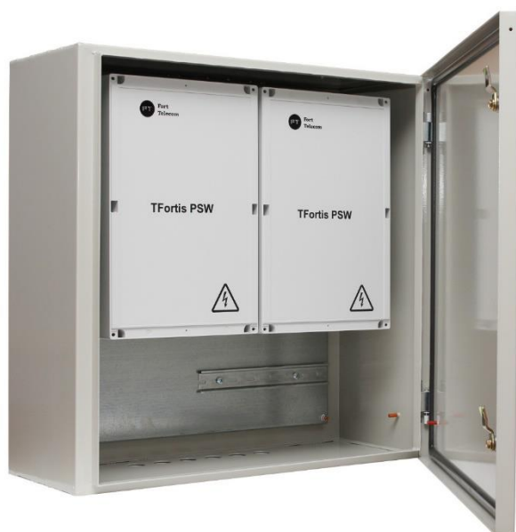
Рисунок 2.1.2 - Вид внутри шкафа с коммутаторами TFortis PSW
